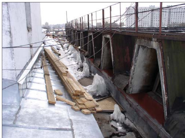
Рис. 6. Наледи на юго-восточных торцах складок. Состояние до ремонта кровли 2007 г.
