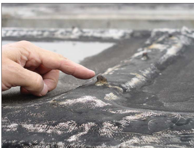
Рис. 4. Состояние мест сопряжений наклонных поверхностей с верхней частью складок до ремонта. 2007 г.
