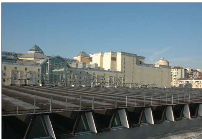
Рис. 10. Отремонтированная кровля главного здания Курского вокзала после сдачи в эксплуатацию в 2008 г.
