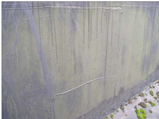
Рис. 5. Состояние боковых наклонных складок покрытых мастикой Кровлелит до ремонта кровли после 37 лет эксплуатации. 2007 г.
